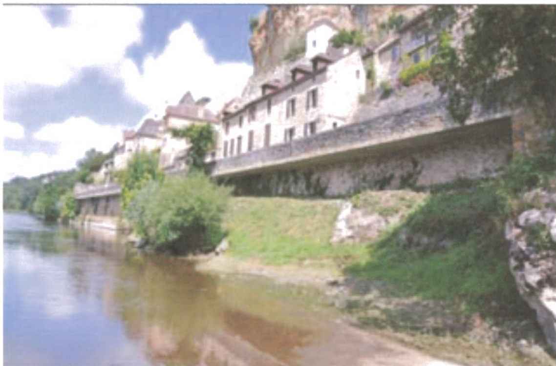
Situation actuelle : le mur de soutènement avec la corniche (source : dossier de présentation)
